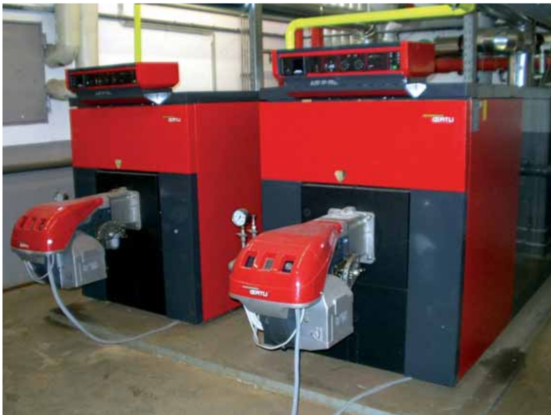
Objekt: POLYSIUS AG ein Unternehmen der ThyssenKrupp Technologies Anlage: 2 x PKR 550-25; 2 x OES 541 insgesamt 2.360 kW Fachunternehmen: Dähne GmbH, Beckum
