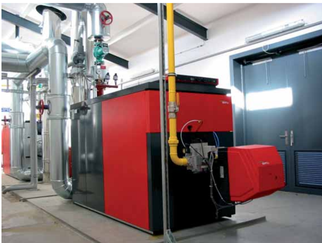
Objekt: Gasübergabestation Finsing Anlage: 2 x PKX 550-16; 2 x OES 443 GI insgesamt 1.550 kW Fachunternehmen: Süddeutsche Anlagenbau GmbH, Roding
